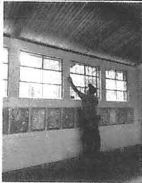
Foto 3: Reemplazo de vidrios ya que hay faltantes
