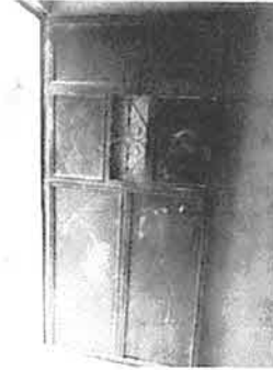
Foto 2: Sustitución de puerta de metal ya que se encuentra picada
