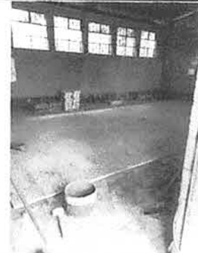
Foto 4: Cambio de piso ya que se encuentra rajado
